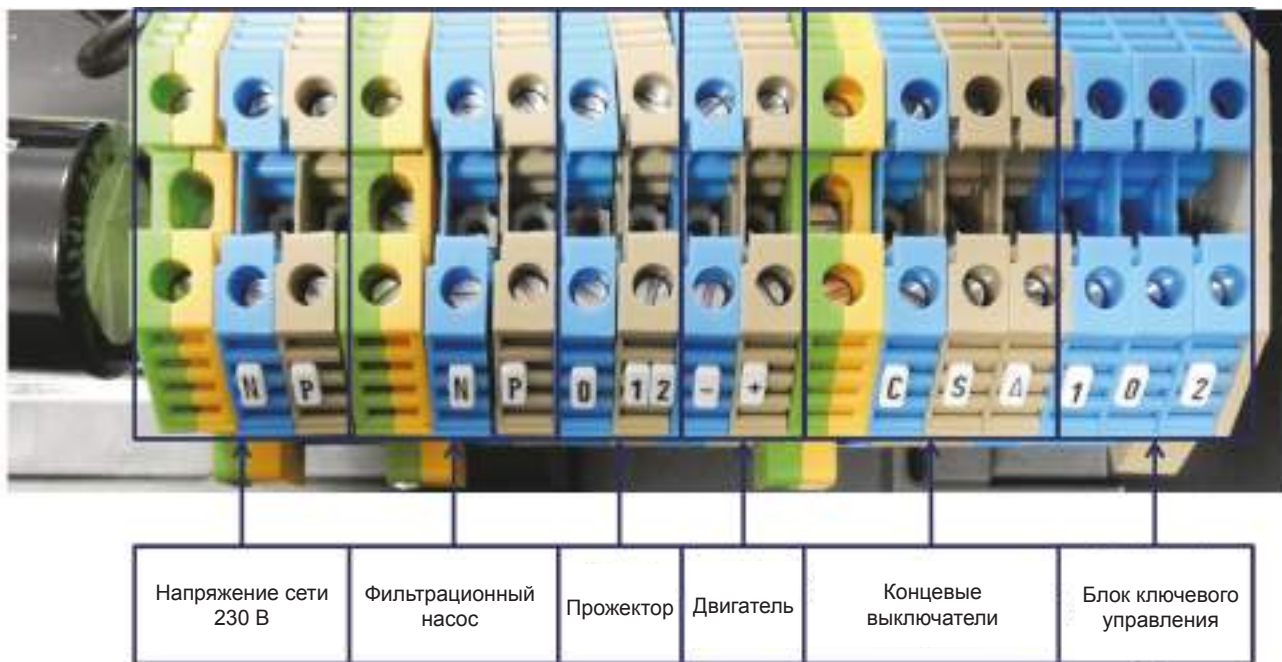
Figure 55 – Электрический щит бассейна PISCINE URBAINE
